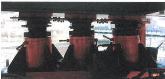
17 Vershublager mit hydraulischer Kopplung © SEH Engineering GmbH
